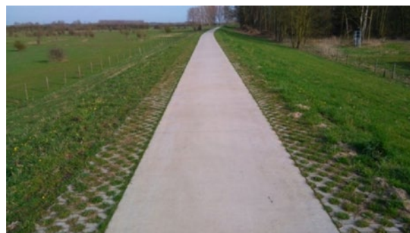
Afbeelding A.4 Voorbeeld van een berm die goed aansluit op de verharding
